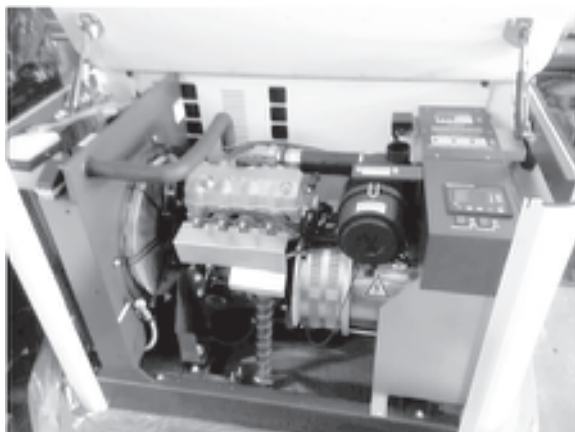
FIGURA 1. Grupo electrógeno de uso domiciliario, sin carteles de advertencia
